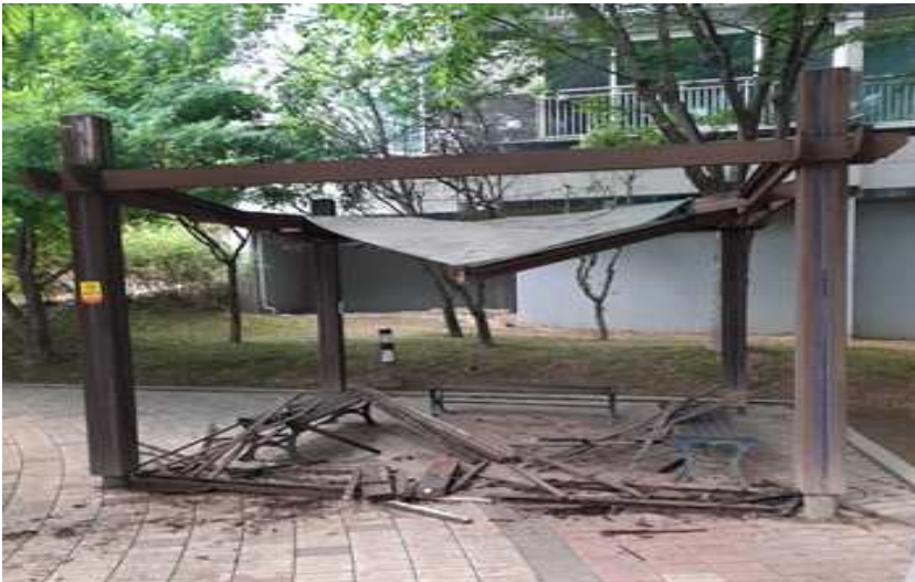
② 사각파고라 지붕 무너짐(철거 전 사진)
